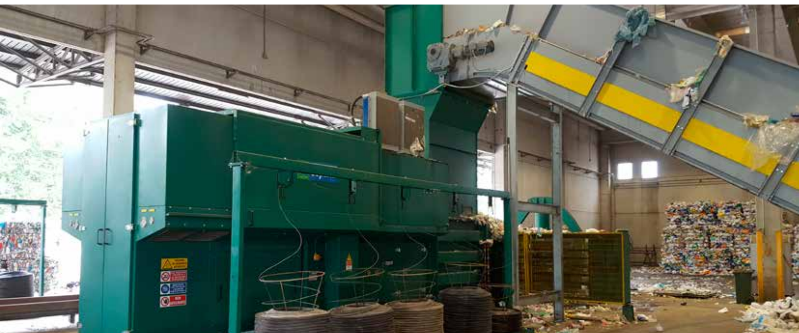
Particolare cabina insonorizzazione centrale oleo-dinamica Pressa mod. PR 300 - Hydraulic unit soundproof cabin detail of Baler mod. PR 300
