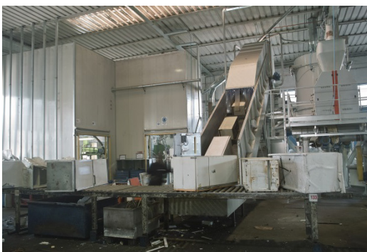
Ligne de recyclage de réfrigérateurs
